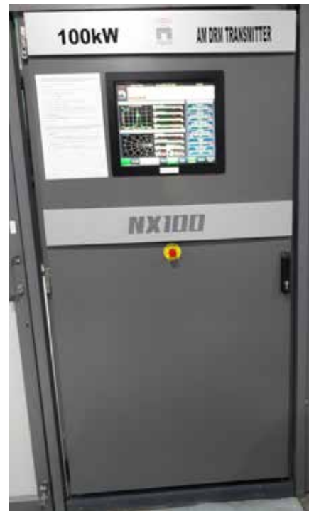
100kW DRM (MW) Transmitter
