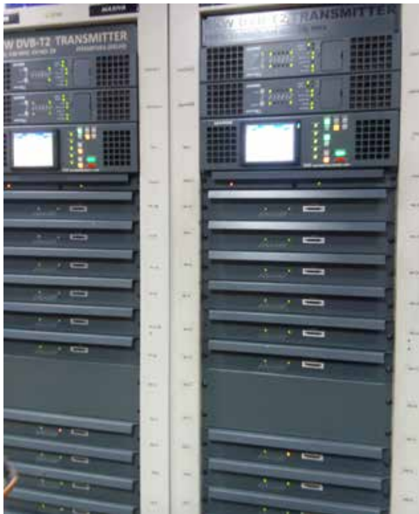
6.0kW DVB-T2 Transmitter
